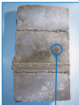
Oberflächenzerstörung im Dieselöltank eines Schiffes
